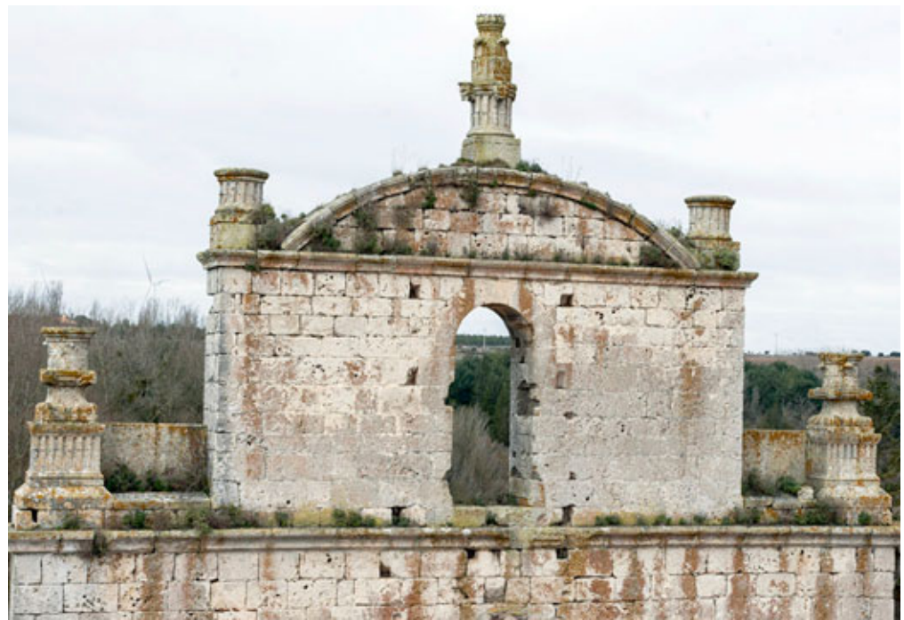
►La vegetación crece entre las piedras de la fachada.
