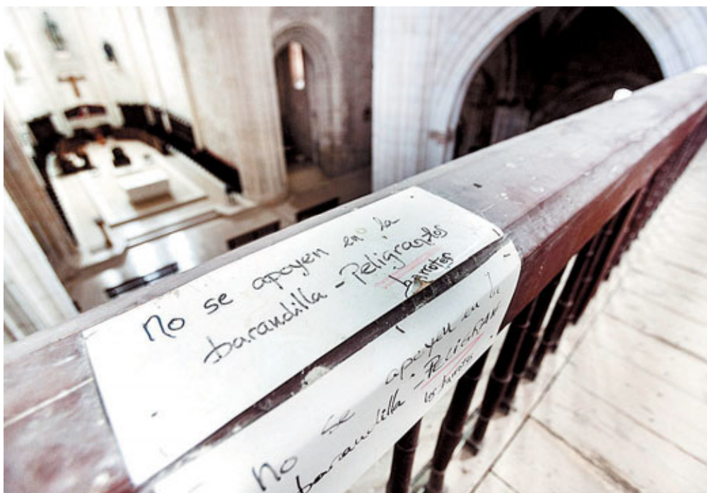
►Unos carteles advierten del riesgo de apoyarse en la barandilla del coro alto.
