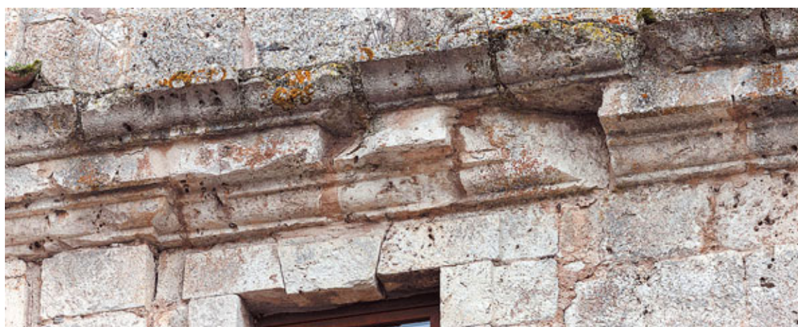
►Detalle de los desperfectos de la fachada.
